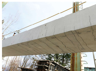
ひび割れ確認状況
