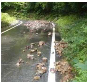
小規模落石の状況
