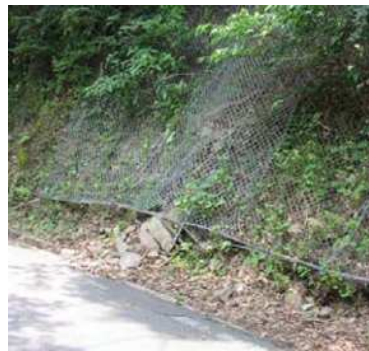
落石防護網裾のこぼれ出し状況
