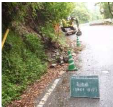
小規模崩壊の状況
