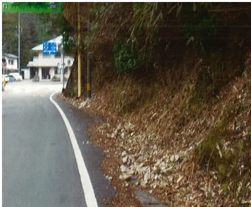
施工前（路肩の小石が落ちている）
