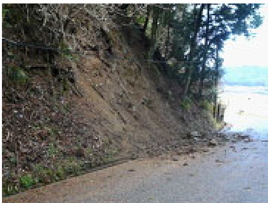
施工前（豪雨により斜面崩壊）
