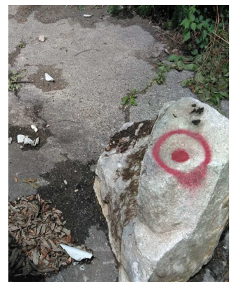
施工後3（基礎に衝突した落石）
